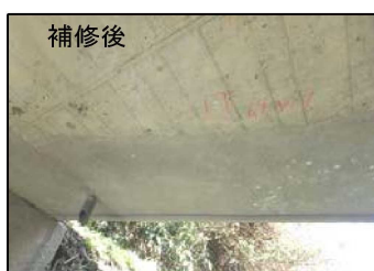
RC床版橋の鉄筋露出
