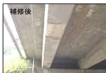
RCT桁のうき
