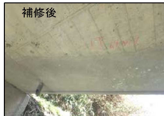
RC床版橋の鉄筋露出
