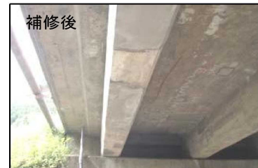
RCT桁のうき
