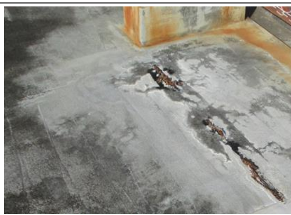
屋上防水：校舎 露出防水層 剥離
