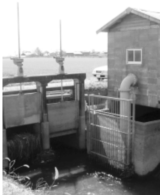
開閉困難な巻上げ井堰
