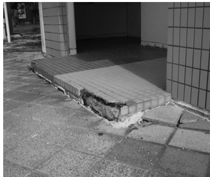
▲段差がひどい中央公園トイレ入口
