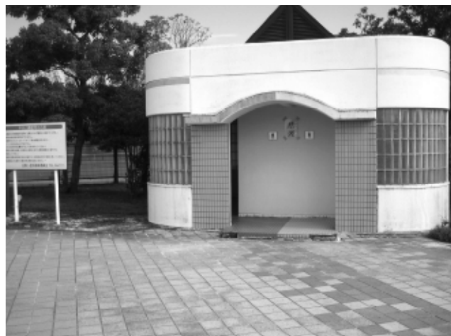
▲大々的な改修が必要となるトイレ入口
