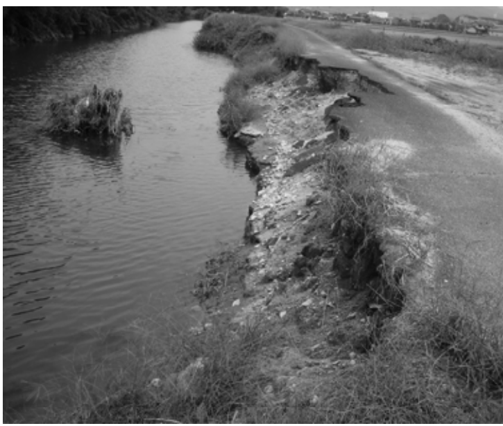
▲7月26日の豪雨で崩壊した田手川堤防(大塚ヶ里)
