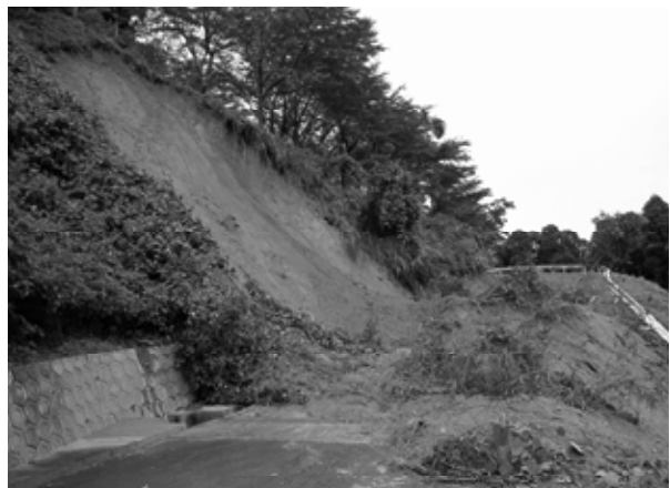
▲7月26日の豪雨で崩壊した林道(永山)
