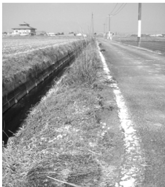
▲浸食された路肩舗装
