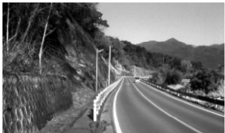
▲ガケくずれの恐れのある運田山付近
