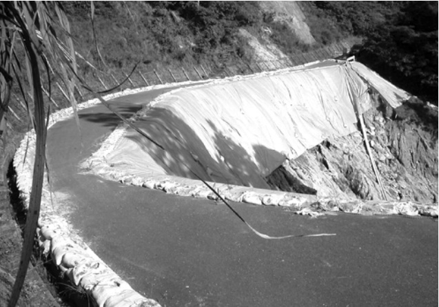
▲林道蛤岳横断線の崩壊現場
