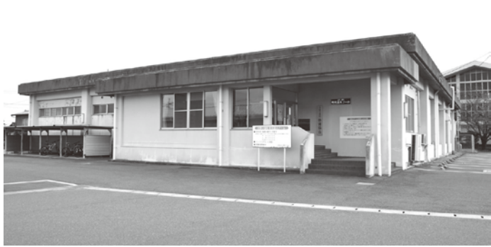
天井が崩落した温水プール
