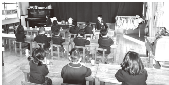
吉野ヶ里保育園雨漏現場（4歳児室）
