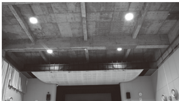
コンクリートむき出しになった中央公民館
