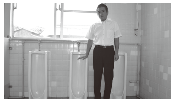
町立保育園のトイレの状況（園児が使用している大人用便器）
