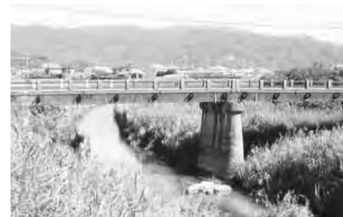
▲改修が待たれる永道橋
