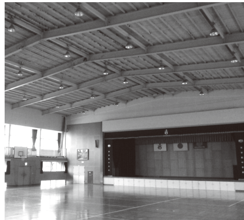
塗装が剥げ落ちている体育館
