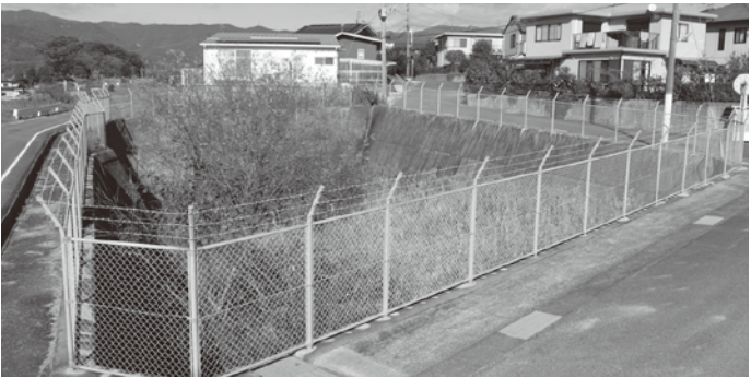
20年間浚渫されていない横田瀬の尾台調整池
