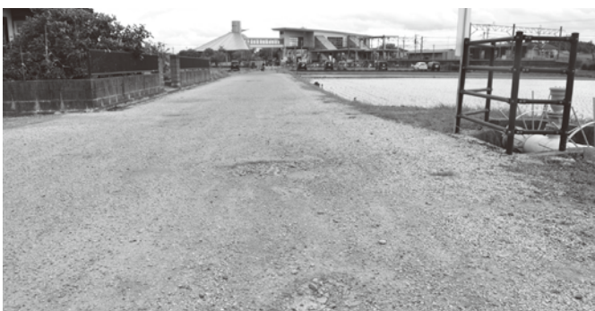
町道田手村～吉田線の凸凹の現状
