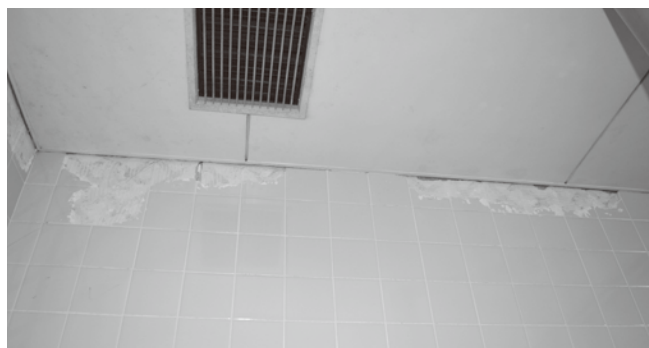
壁が落ちた温水プール
