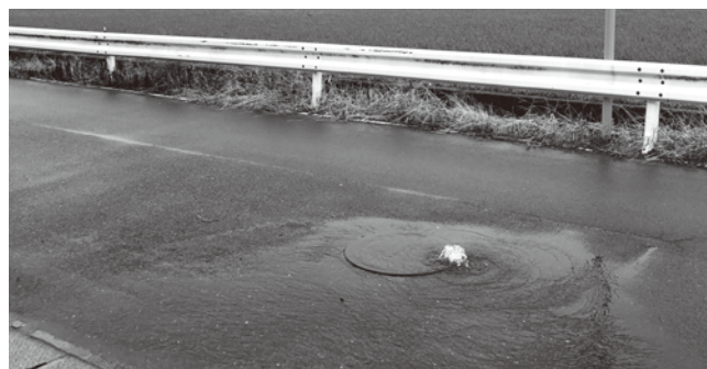
不明水流入によりあふれ出ている現場
