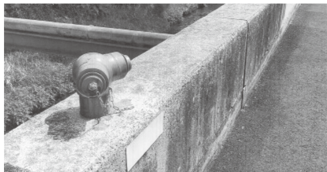
若楠団地東側の送水管
