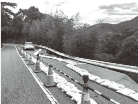
国道385号陥没状況
