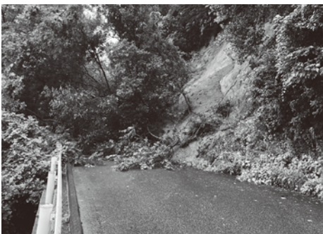
林道佐賀東部線崩土状況
