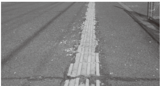
割れたり劣化している誘導ブロック
