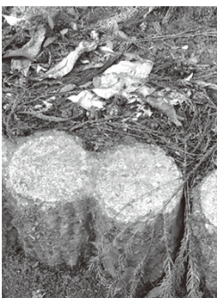
段差ができている遊歩道
