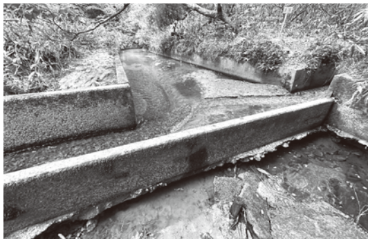
豪雨被害等で崩壊している「蛤水道」の水路
