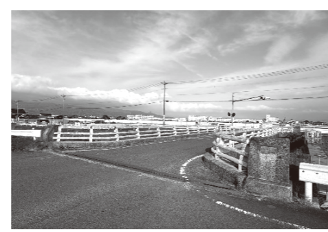
老朽化し更新できない一灯式信号機【豆田橋】
