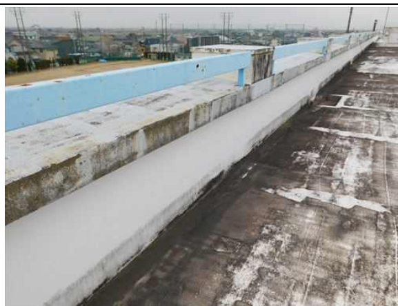
屋上防水：校舎 立ち上がり・笠木 塗装の劣化
