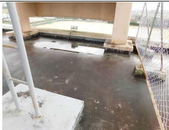
屋上防水：校舎 水溜まり
