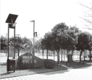
中央公園に設置された太陽光外灯
