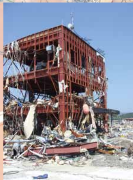
被災した南二陸町防災対策庁舎 （被災地派遣職員撮影）
