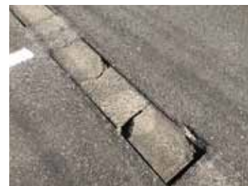
道路側溝蓋の破損
