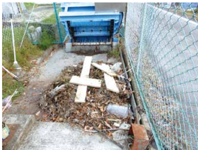
除じん機にゴミがたまっている様子
