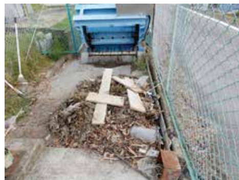
除じん機にごみがたまっている様子
